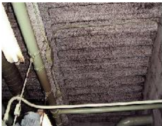
石綿含有吹付けロックウール
