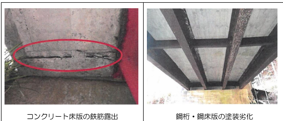
補修の対象となるような損傷
