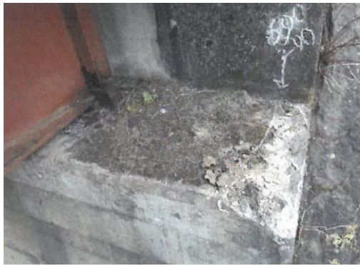
橋の端部の土砂堆積
