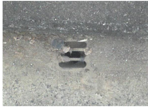
排水設備の土砂詰まり
